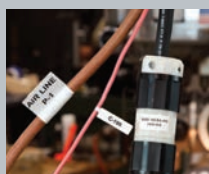
Identificação para Componentes Elétricos
